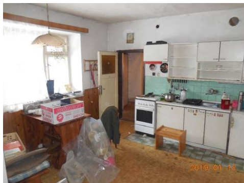
Dům čp. 16 před začátkem oprav.
